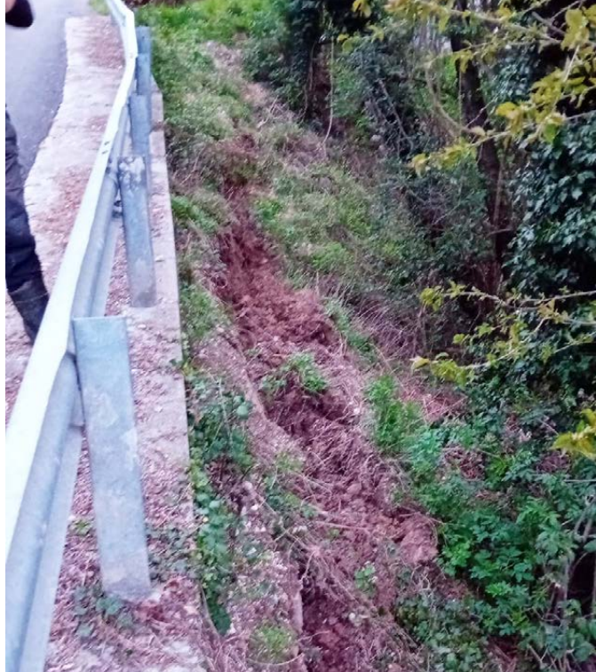
Die Schadstelle in Hinterglen
